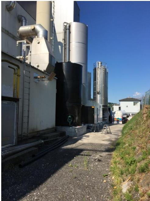
Abbildung 2: Blick auf die Neuanlage. Im Vordergrund in der Mitte der schwarze Schlammsammeltank, dahinter der hohe Misch- und Ausgleichsbehälter und der Hauptcontainer (weiß).
