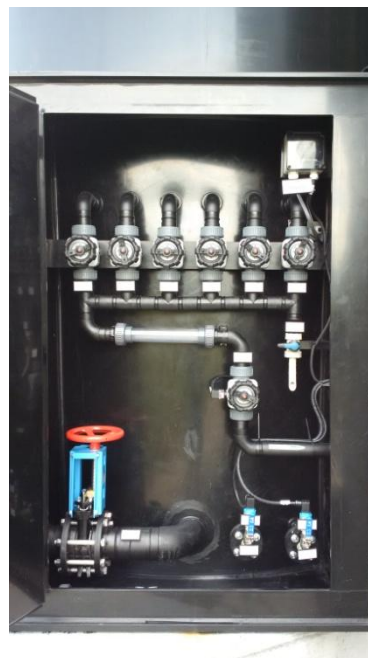
Abbildung 5: Klarwasserschrank am Schlamm-behälter zum Abzug des Trübwassers.
