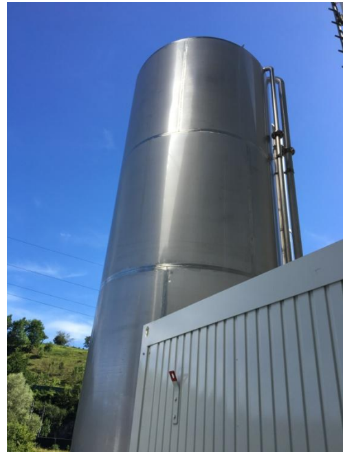
Abbildung 3: Misch- und Ausgleichsbehälter. Im Vordergrund rechts unten der große Abwassercontainer.
