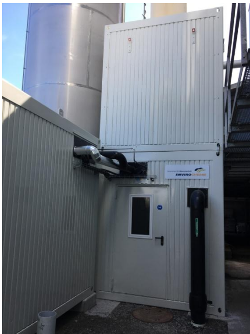
Abbildung 4: Oben Container mit Trommel-sieb-anlage. Unten Container mit Rechen-ab-wurf und Pumpstation.
